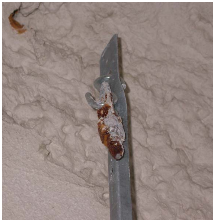
Farbabb. 4: Durch wasserstoffinduzierte Spannungsrisskorrosion gebrochener Bolzen
